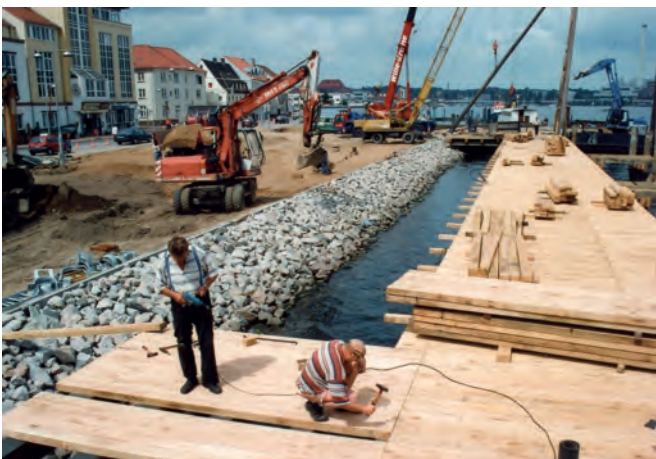
B au einer Plattform für die Wachhütte (heute Bens Fischbude) und der Zugangsbrücken der Heckanleger. Im Hintergrund die Neuaufstellung der KRAHN Replik.
